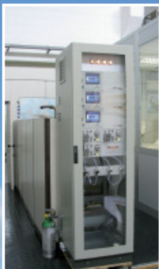
Monitoraggio CO, O2 e Temperatura in tre camini
