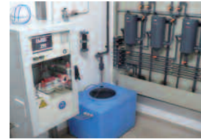
Installazione analizzatore COD multistream
