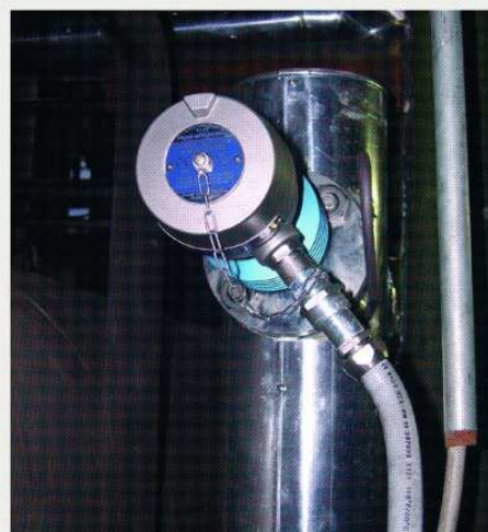
Installazione in raffineria (produzione di bitume)
